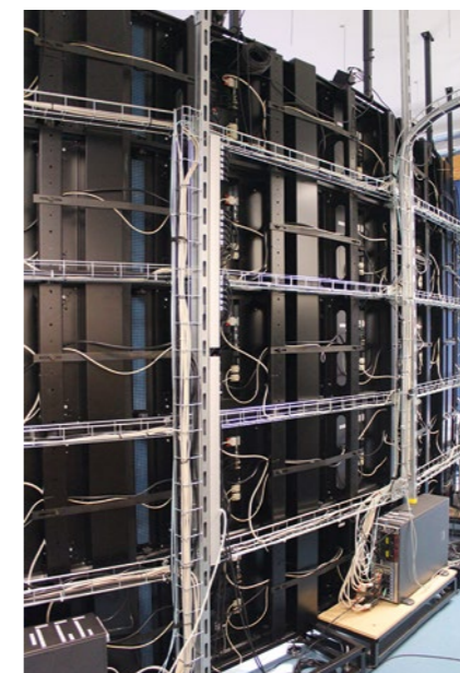
3 Workstations mit je 3 Hochleistungsgrafikkarten ermöglichen die Zuspiegelung von 35 Full-HD-Signalen auf die Videowand.
